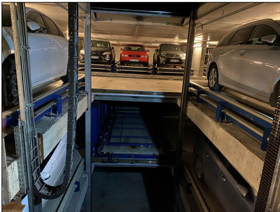
7. kép A liftaknák komoly veszélyforrást jelenthetnek [szerző saját fotója]
