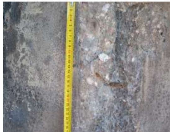
A levált és elszíneződött beton (2017. 30. 31)
