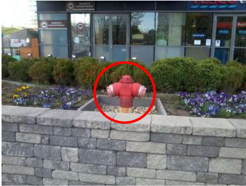
4. kép Támfal mögötti tűzcsap, kavicssal feltöltött betonkeretben [15]
