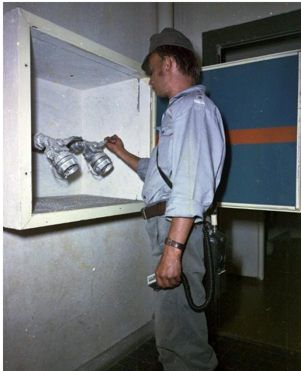
3. melléklet: Golyós csappal ellátott felszálló vezeték ellenőrzés, egy társasházi közös helyiségben. Forrás: Hózer Benjámín gyűjteménye.
