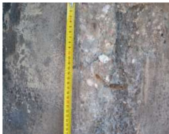
A levált és elszíneződött beton (2017. 30. 31)
