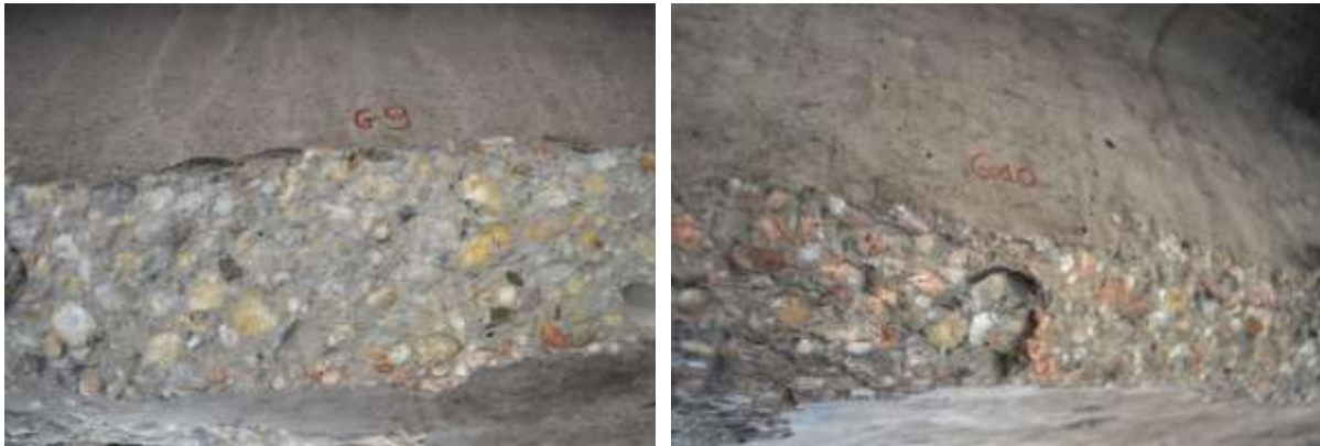
9. ábra: A levált betonfelületek és az adalékanyag áthatadt felületei (2017.07.12)
