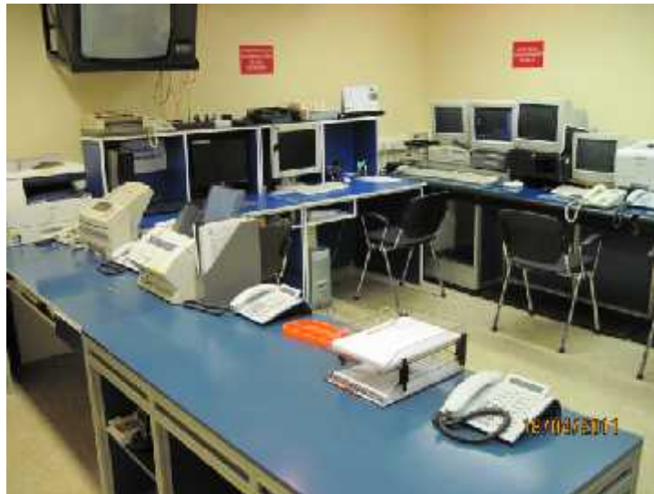
3. fénykép. Kommunikációért felelős berendezések helysége, forrás: PA Zrt.
