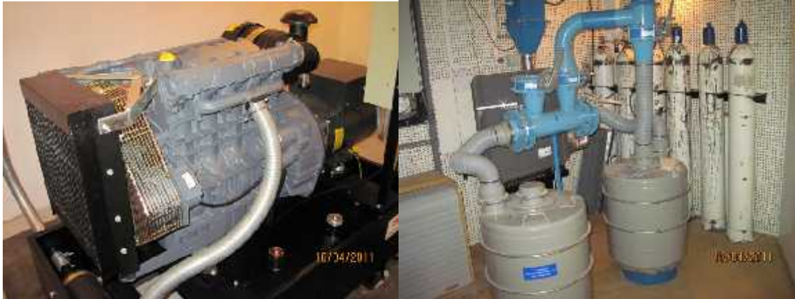
4. fénykép. Védett Vezetési Pont dízel generátora és hermetizálás esetén a levegő tisztító rendszere, forrás: PA Zrt.
