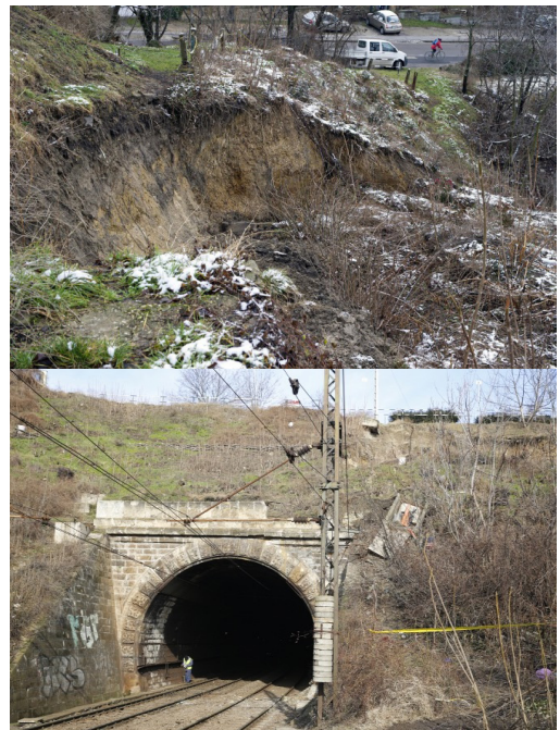
17. ábra: Alagút támfal földcsuszamlása (forrás saját)
