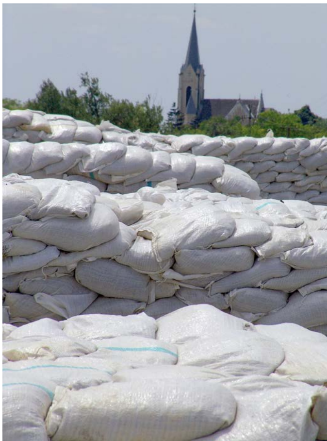
2. kép: Rézsúcsúzás és buzgár elleni védekezés 2006-ban a Hármaskörös árvédelmi töltésén Szelevénynél, ahol a lakosságot kitelepítették, és a község csak "Isten kegyelmének" köszönhetően menekült meg az elöntéstől. Fotó: SCHWEITZER F.
